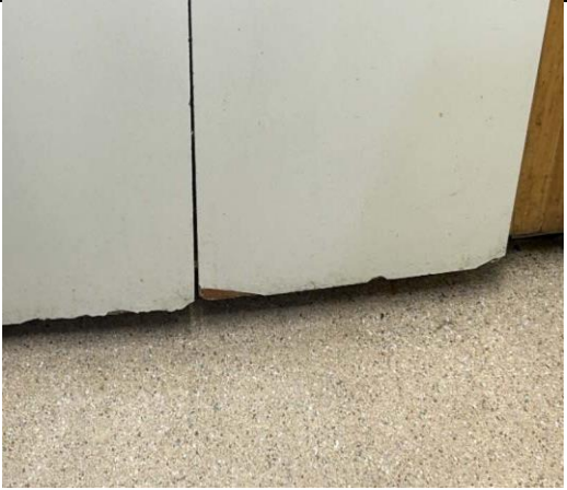
Armarios de cocina desconchados/desgastados
