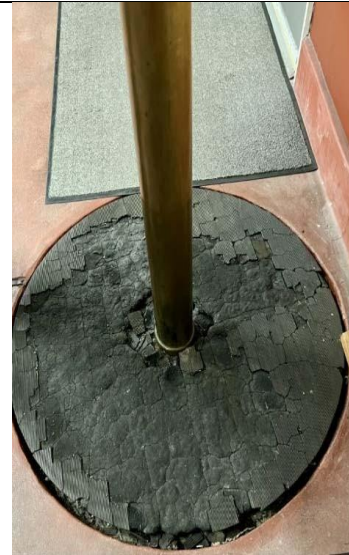
Mal estado de la pista de aterrizaje del poste de bomberos
