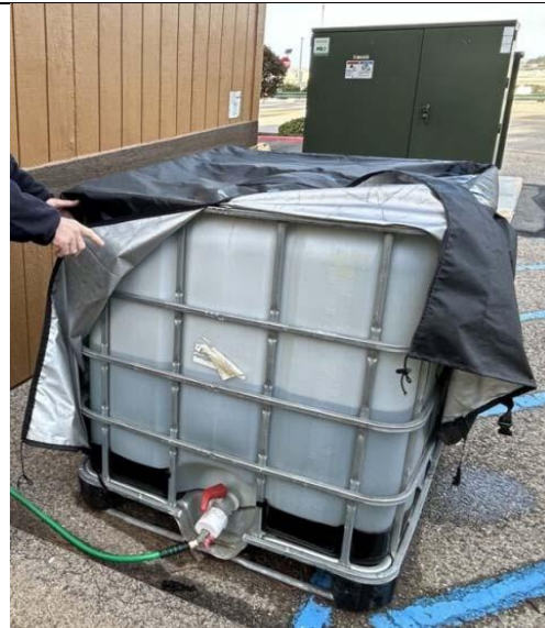
Suministro de agua no potable
