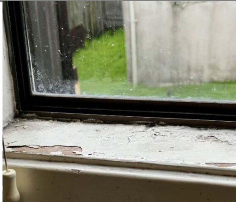
Pintura del alféizar de la ventana descascarillada
